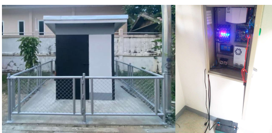
รูปที่ 10 แสดงสถานที่ติดตั้งอุปกรณ์ไมโครสมาร์ทกริดที่ใช้ในงานวิจัย
