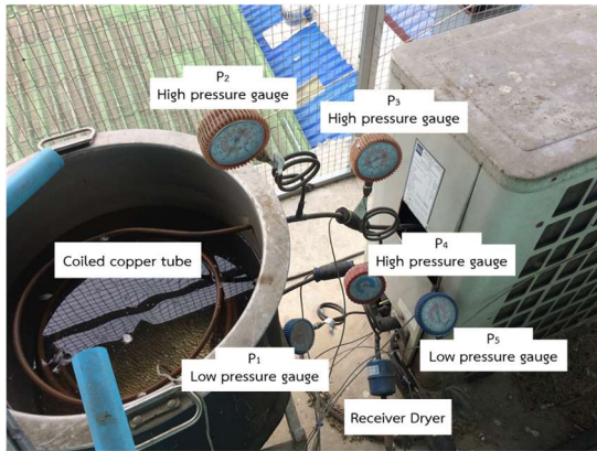
รูปที่ 2 ระบบปรับอากาศที่ติดตั้งถึงกักเก็บ พลังงานความร้อน [3]
