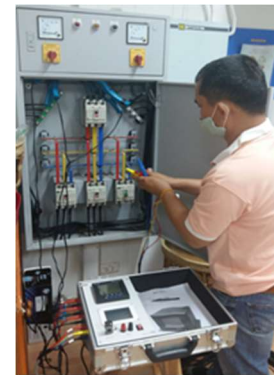
รูปที่ 2 ติดตั้งอุปกรณ์เก็บข้อมูลการใช้ไฟฟ้าของอาคาร
